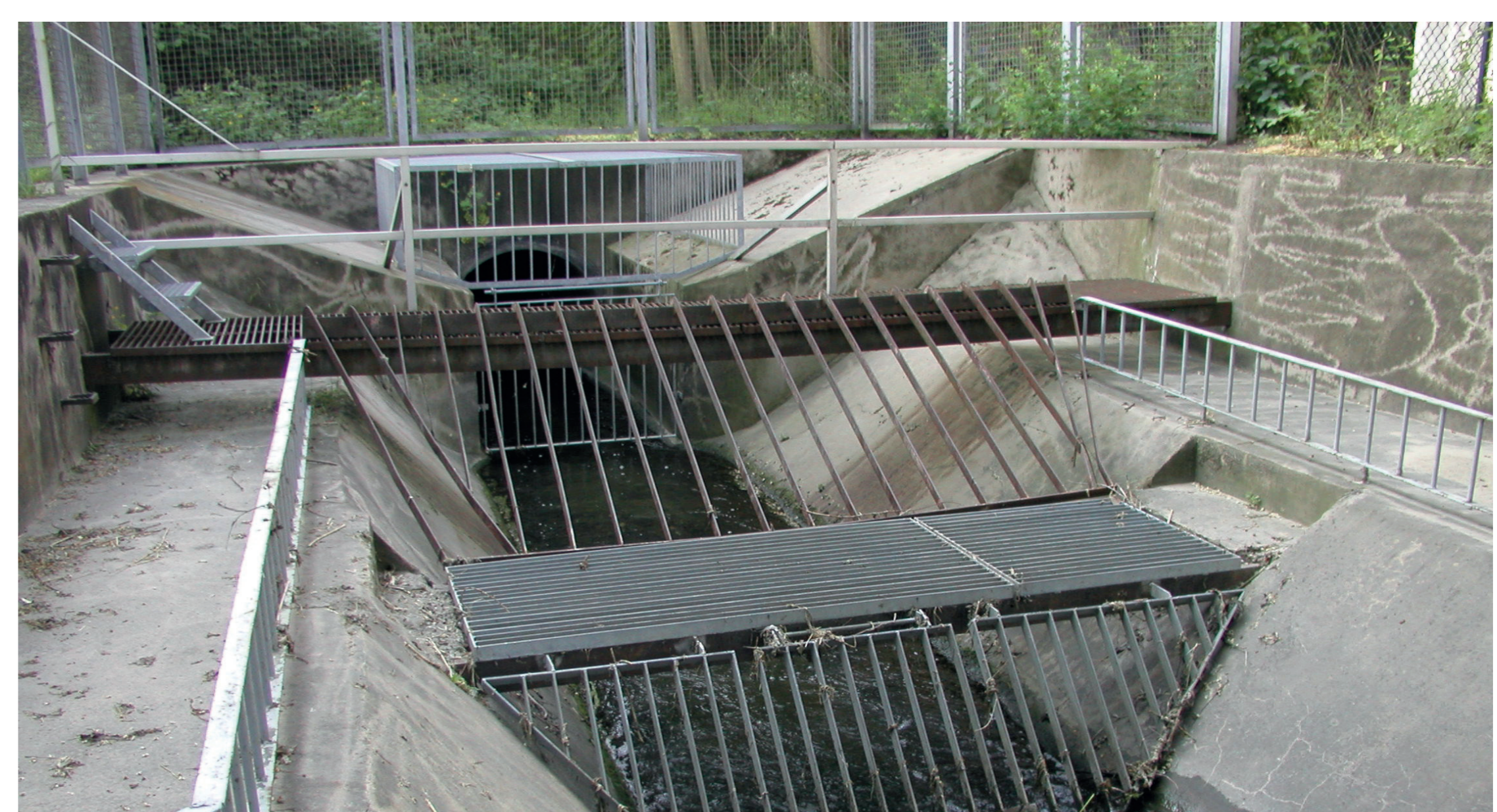
Überflutungsvorsorge: Zusätzlich Einbau von Rechen und Sandfängen am Übergang Gonsbach
