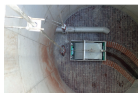
...in den Drosselschacht mit Drossel-element zur Drosselung von Regenwasser
