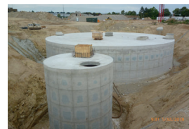
Regenrückhaltebecken und Drosselschacht
