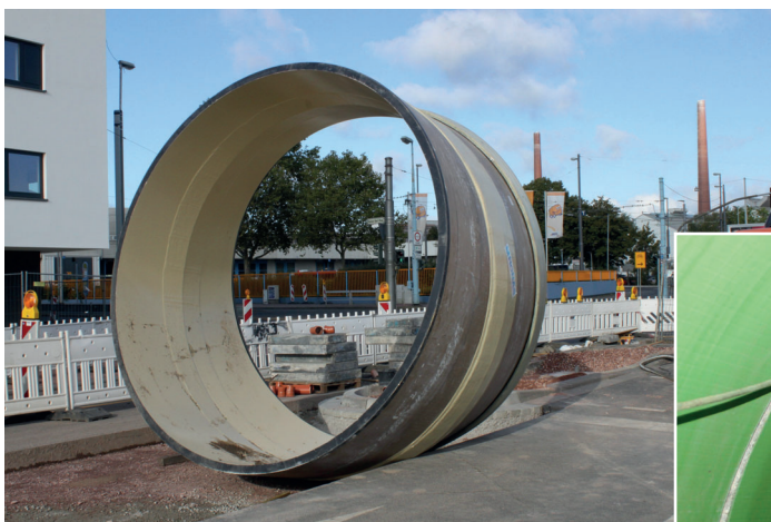
Begehbare Stauraumkanal in der Rheinallee mit beachtlichen 3,60 m im Durchmesser
