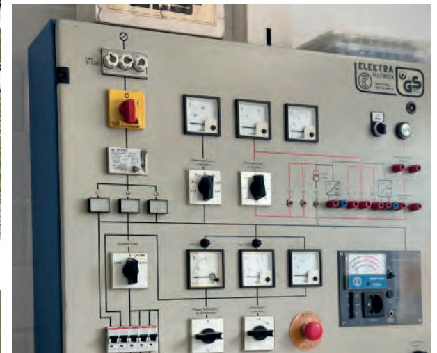
Schaltanlage für die Abwasserreinigung
