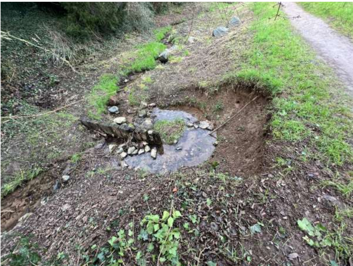
Abbildung 41: Auskolkung des Uferbereiches im Januar 2023 (Blick in Fließrichtung)
