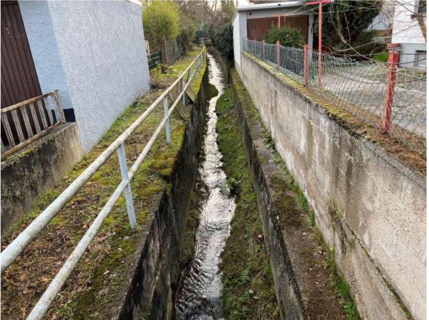
Abbildung 48: Ablagerungen im Aubachs unterhalb der Kita
