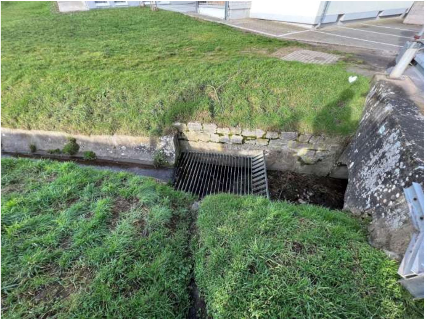
Abbildung 20: Großes Gitter zum Treibgutrückhalt vor dem Brückendurchlasses des Aubachs (Fließrichtung von links nach rechts)
