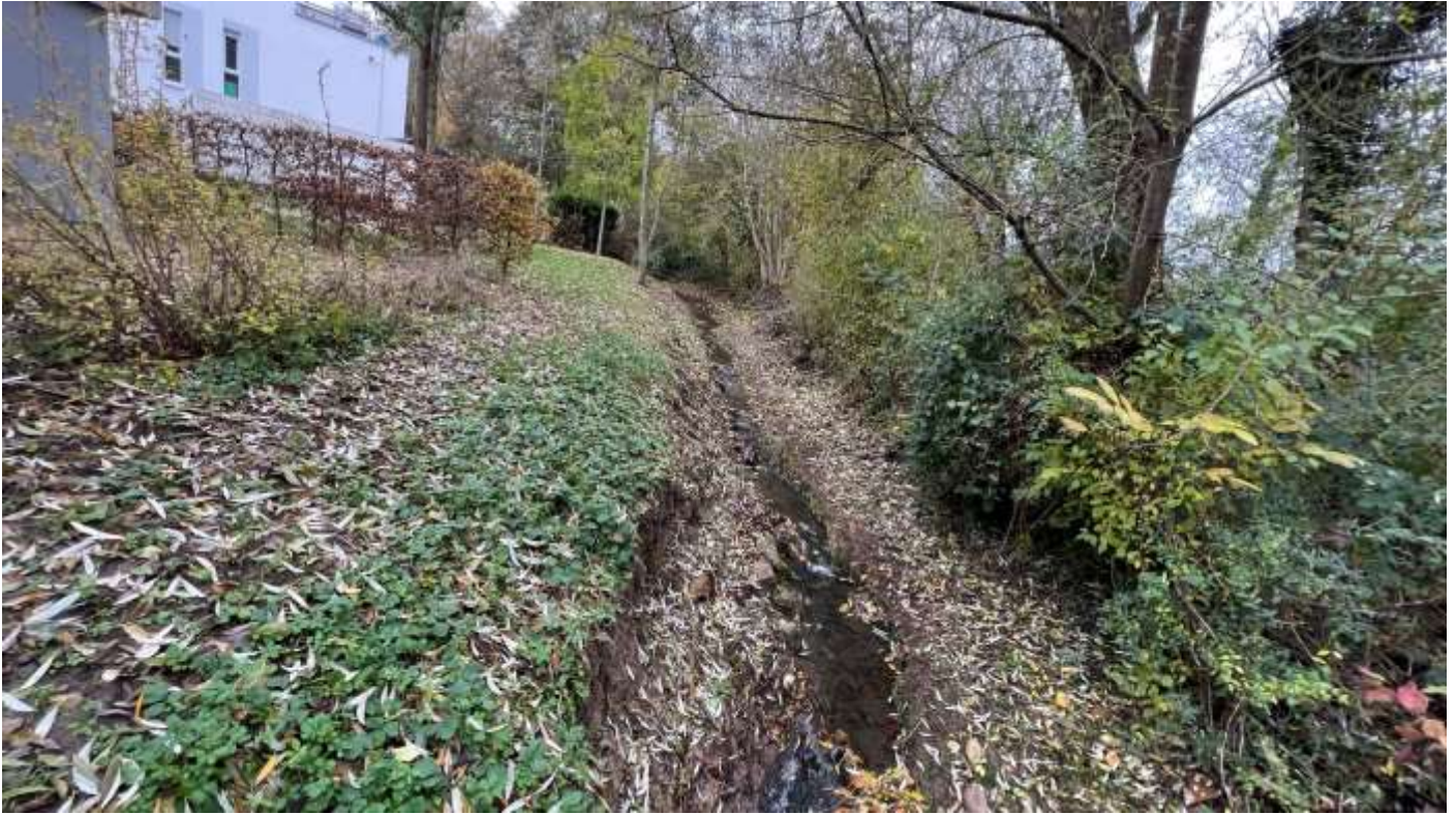
Abbildung 79: Auskolkung des Gonsbachs (Blick entgegen der Fließrichtung)
