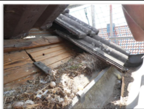
3.Sofortvollzug, Öffnung der belegten Niststandorte, Freigelegte Nester von Mauerseglern und Sperling
